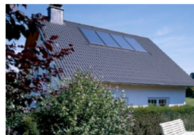
Dom jednorodzinny z systemem solarnym do dodatkowego wspomagania centralnego ogrzewania
