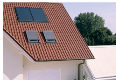
Dom jednorodzinny z systemem solarnym do przygotowywania ciepłej wody
